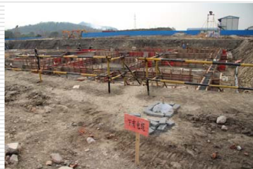
埋地电缆标志牌
