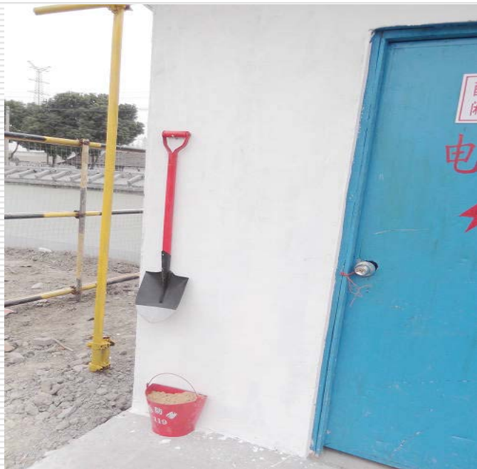
电房消防设施的配备
